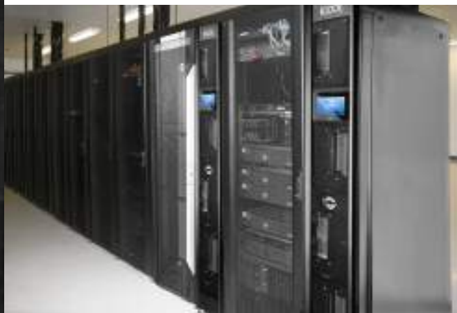
حفظ محصولات قدیمی و نیز افزودن تجهیزاتی نظیر رک و سیستم‌های سرمایشی جدید در کنار تجهیزات قدیمی
