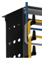
شکل عبور کابل‌ها از نگهدارنده کابل
